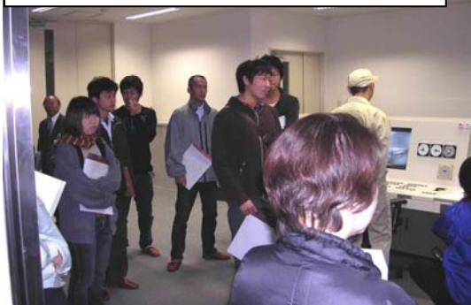
容器包装プラ処理設備の運転制御室
