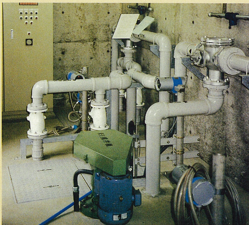
理学部実験洗浄排水槽
